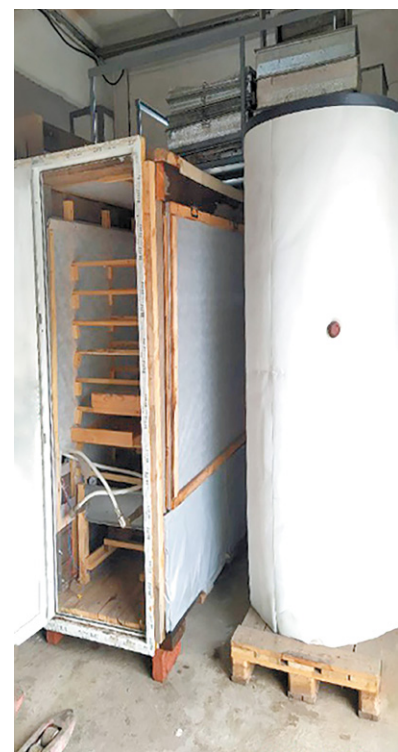
Расположение солнечной сушилки в цехе рядом с баком-аккумулятором горячей воды солнечной системы горячего водоснабжения
